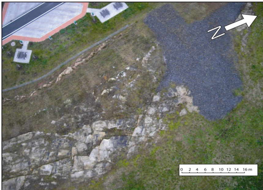
Abbildung 34: Flugbildaufnahme am Thüringer Tor zur Erfassung der horizontalen Ausbreitung von Klüften im Buntsandstein (smS). Aufnahmehöhe ca. 70 Meter.
