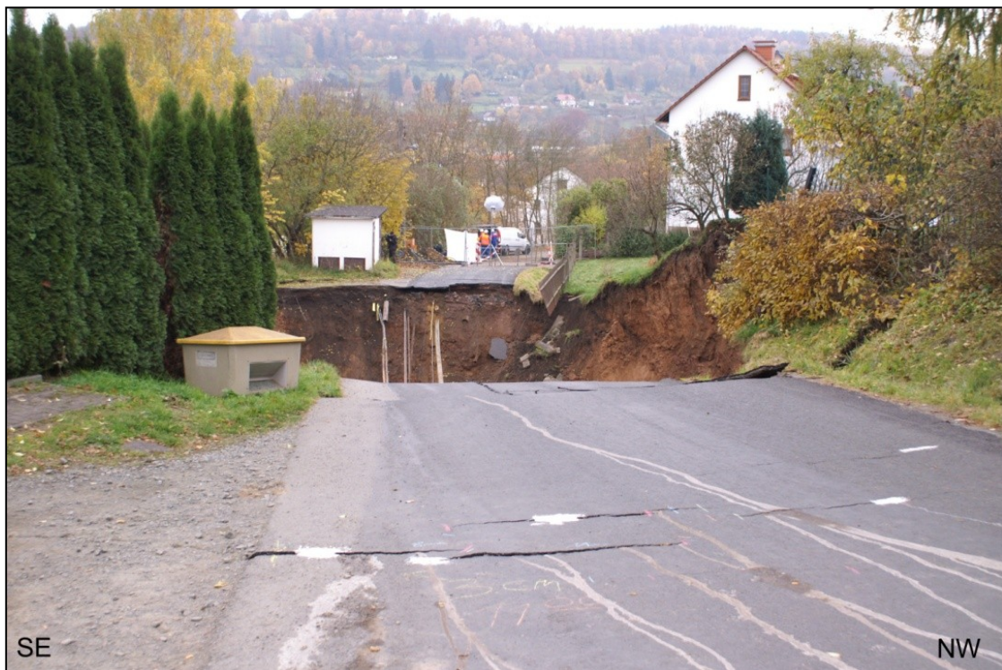
Abbildung 68: Erdfall in Schmalkalden vom 01.11.2010. Der an die Heßlesser Störungszone gebundene Erdfall besitzt einen Durchmesser von ca. 25 Metern. Im Vordergrund sind umlaufende Rissstrukturen zu erkennen, die mit Gipsmarkern versehen wurden um weitere Sackungs- und Rutschererscheinungen zu erkennen.
