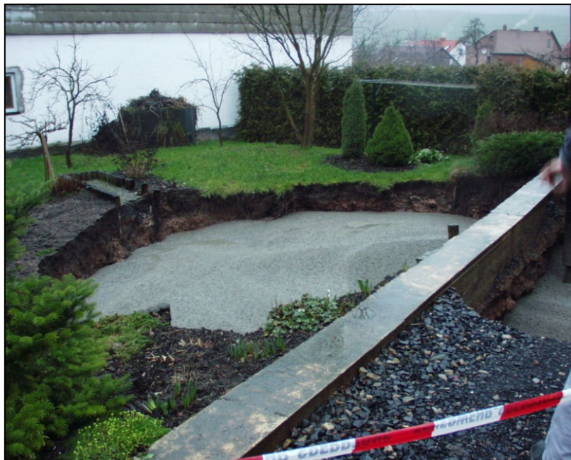
Abbildung 67: Erdfall in Tiefenort vom 24.01.2002. Der Erdfall wird durch eine Betonplombe verschlossen. Am 28.01.2010 sackte die Erde an gleicher Stelle erneut nach.
